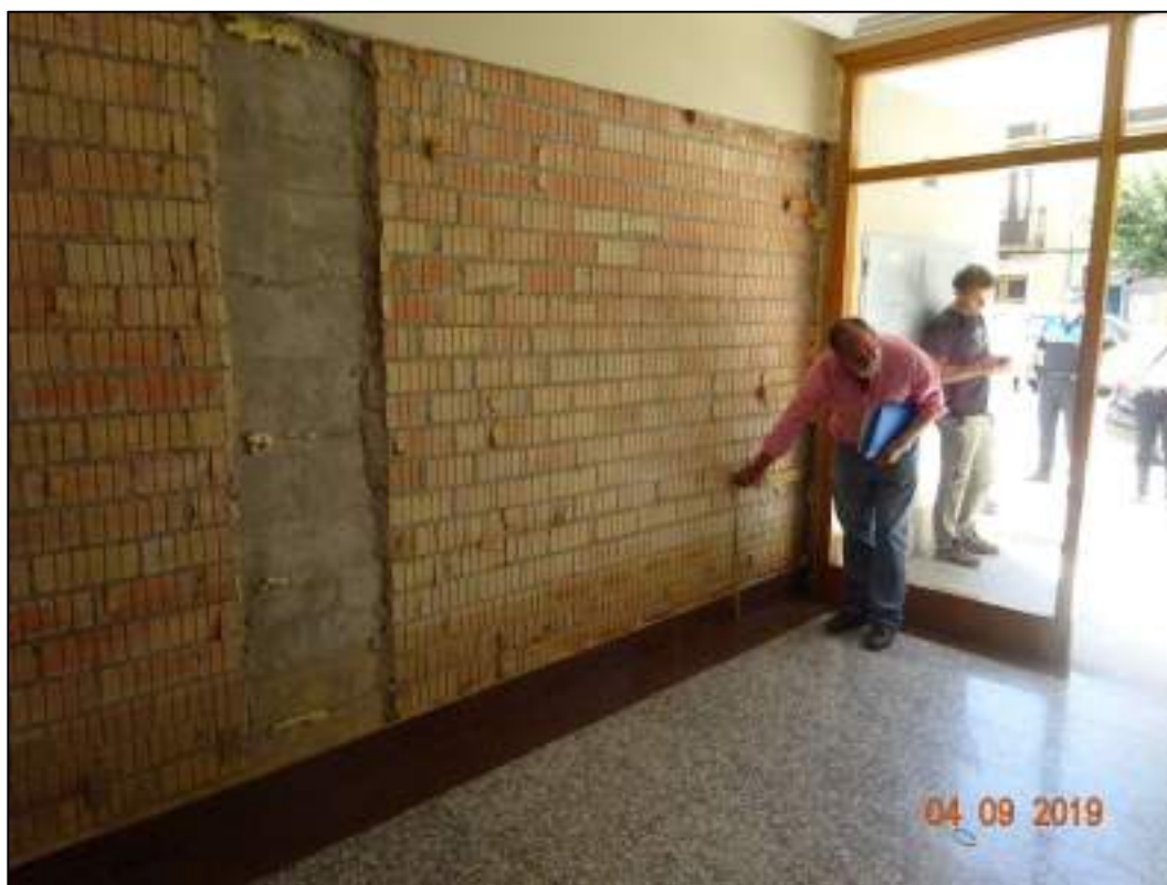
Ilustración 61. Trabajos de reparación en un portal de la Avenida de Sangüesa (nº 11) que resultó inundado durante la crecida del Cidacos, que anegó parcialmente esta calle.
