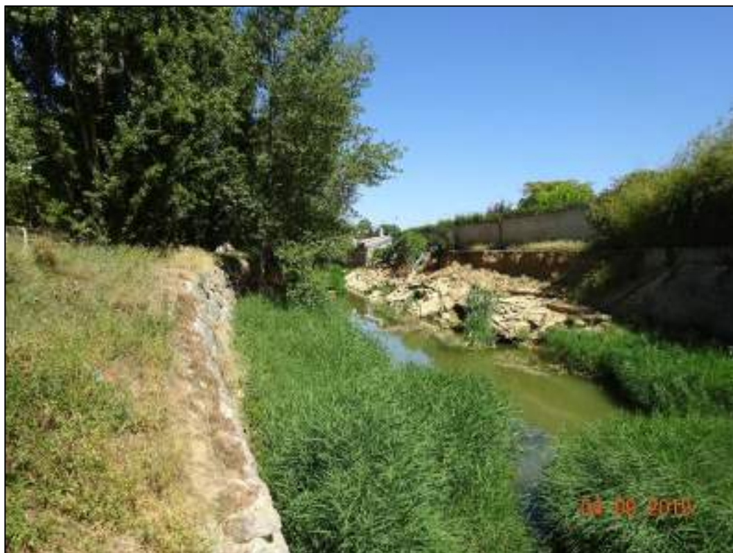
Ilustración 67. Afecciones de la riada de julio de 2019, en la margen izquierda, a la altura de la Agrupación Deportiva Rekarte.
