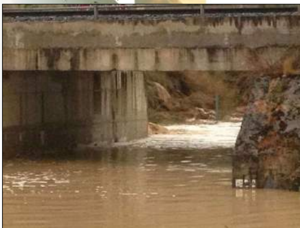
Ilustración 44. Paso bajo las vías del tren inundado en la zona del polígono Fuente El Rey. Imágenes realizadas por Policía Municipal de Tafalla y obtenidas del informe elaborado por Tenada S.L.U. por encargo del Ayuntamiento de Tafalla.
