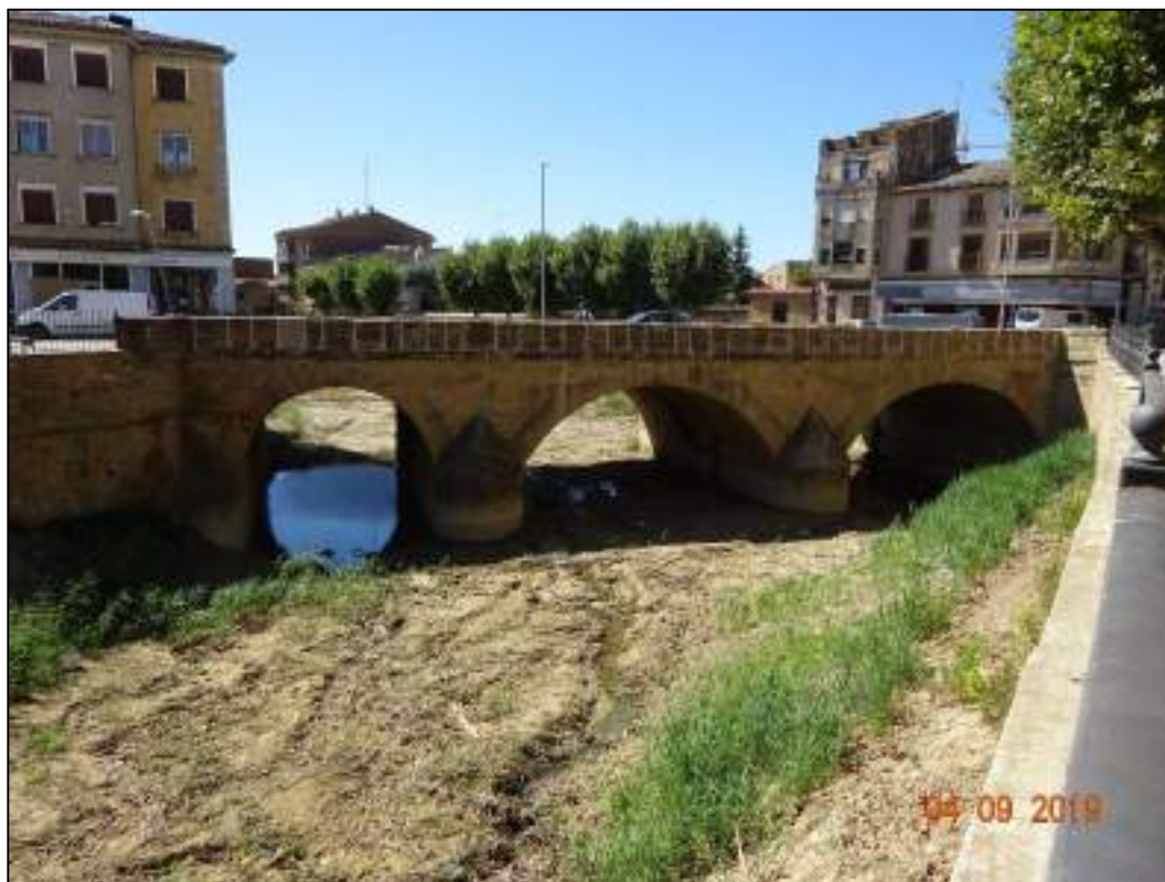
Ilustración 64. Vista del puente de la carretera NA-132 sobre el Cidacos en Tafalla, con sus ojos completamente limpios una vez concluidos los trabajos de retirada de los vehículos depositados por el río en su cauce. Los pretilos del puente aparecen ya reparados también.
