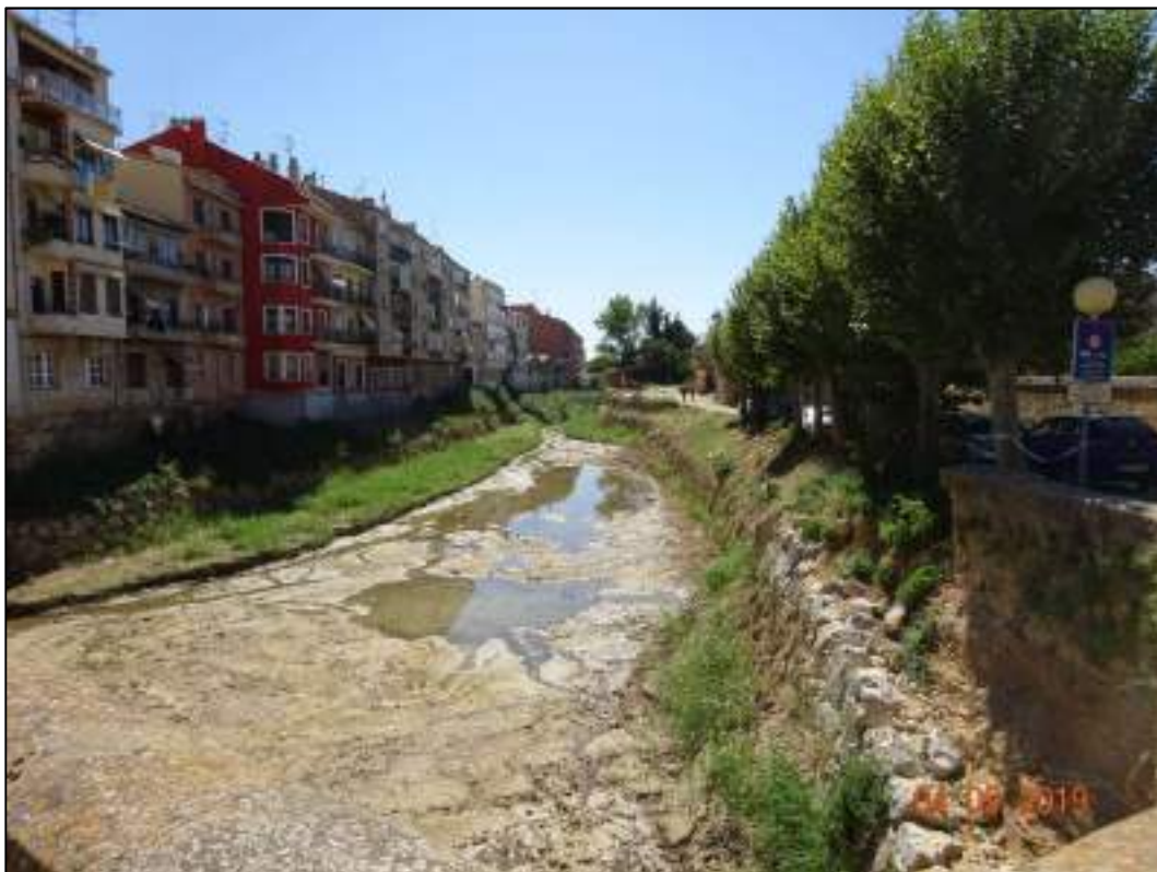
Ilustración 62. Vistas del cauce del Cidacos, desde el puente de la NA-132, hacia aguas abajo, casi dos meses después del evento de julio de 2019.
